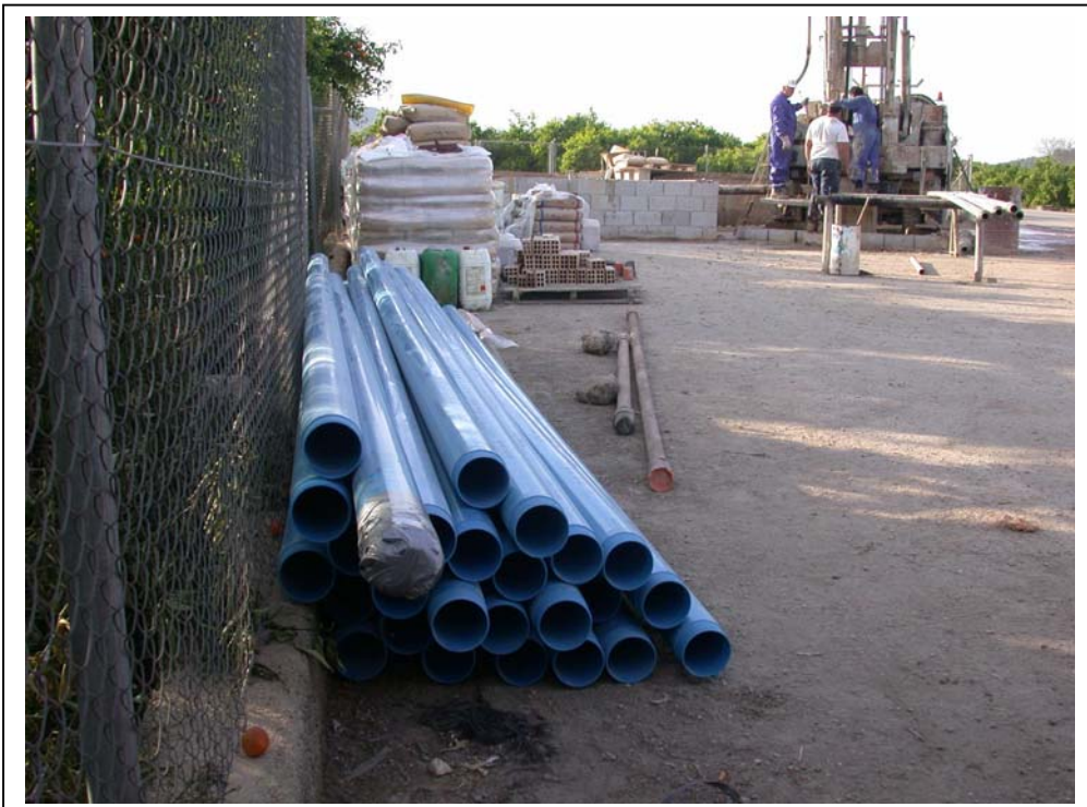
Detalle de la tubería de PVC utilizada
